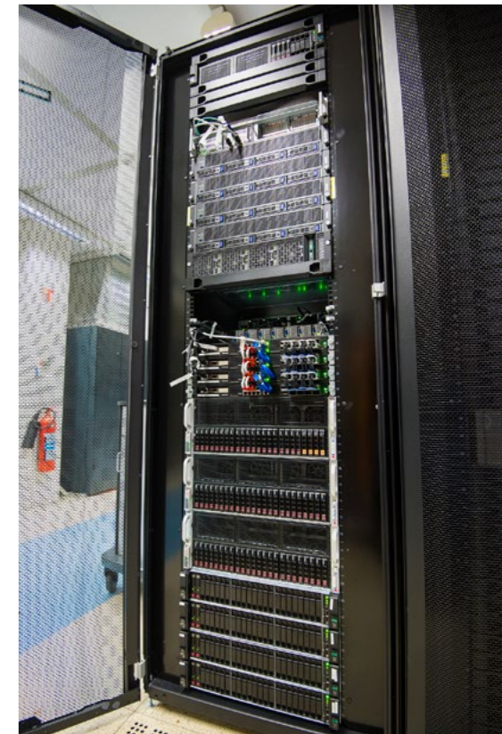
Eines der Racks der Future Technologies Partition (FTP). (Foto: Simon Raffener)
